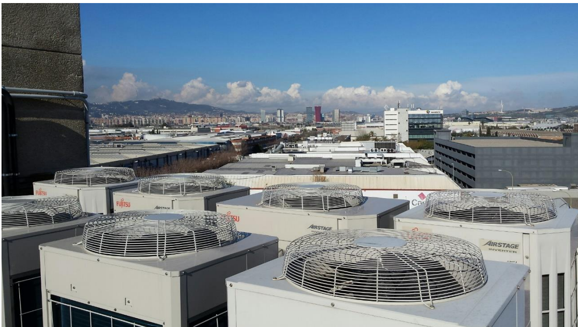
Sistema VRF de Fujitsu instalado en un hotel localizado en Barcelona
